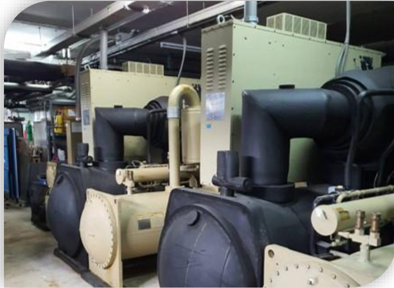
รูประบบ Smart Chiller ที่ติดตั้งที่อาคารทิม
