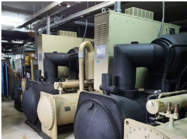
รูประบบ Smart Chiller ที่ติดตั้งที่อาคารทีม
